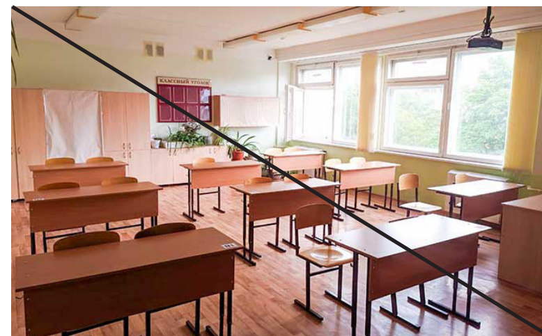
Плохо Линолеум под дерево
